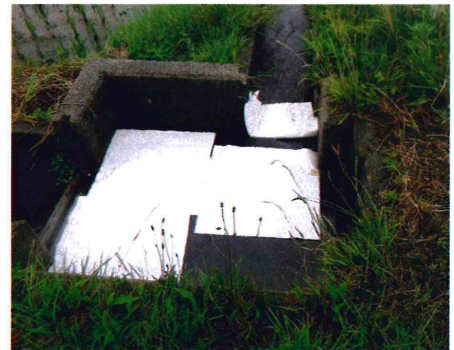
油流出処理状況 (新堀地内)
